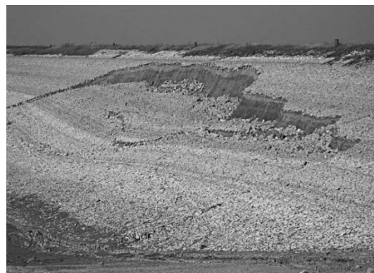
Фиг. 3. Обрушване на водния откос на стената
